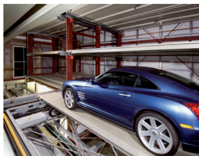
08 Nach dem Erreichen des vorgesehenen Lagerfachs wird die belegte Parkpalette bei der zweireihig tiefen Anordnung mit der dahinterliegenden Parkpalette gekuppelt und vom Shuttle in das Lagerfach geschoben.
