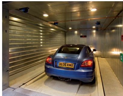
02 Nach dem Anwählen des Stellplatzes parkt der Fahrer den Pkw auf einer Parkpalette im hell erleuchteten Übergabebereich.
