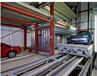
07 Der Vertikallift hebt sich an (Y Richtung), gleichzeitig bewegt sich das Shuttle horizontal (X Richtung). Das seitliche Tor wird geschlossen und eine unterhalb der Übergabekabine vorpositionierte Parkpalette wird in die Übergabekabine gehoben.
